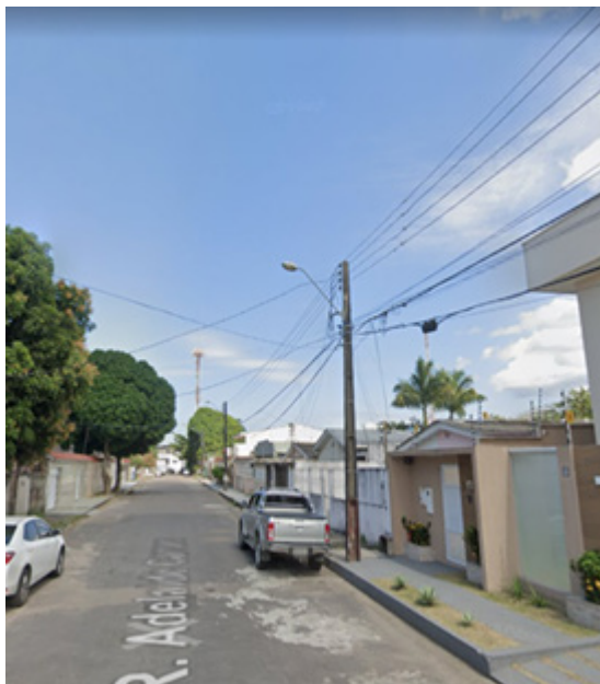
Rede Convencional – Exemplo de Rede Elétrica Precária com Conexões Clandestinas que evidencia também o risco à população
