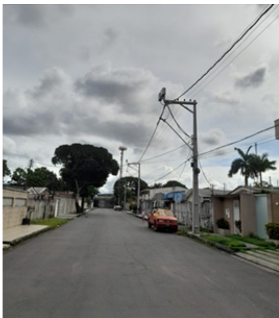
Rede Blindada com Sistema de Medição Centralizada – Modernização da Rede Elétrica, Redução das Perdas e eliminação de risco à população
